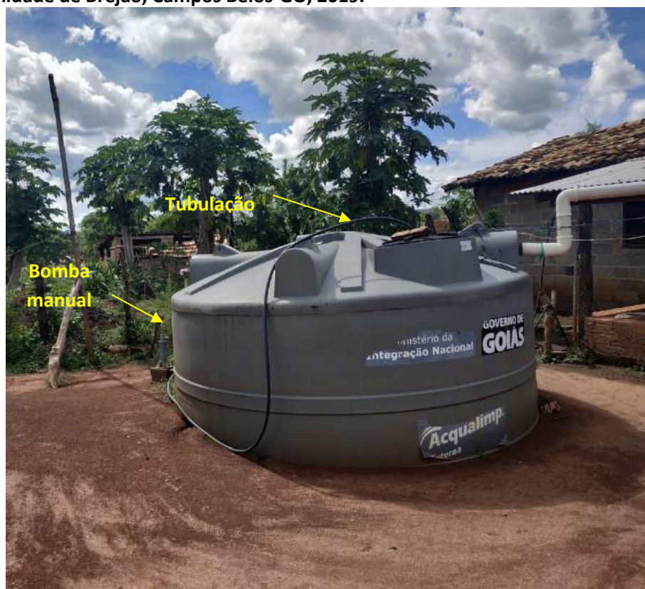
Foto 6.6 – Domicílio que utiliza a cisterna como reservatório domiciliar, armazenando água do SAA, Comunidade de Brejão, Campos Belos-GO, 2019.
