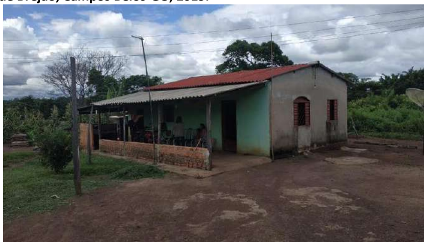
Foto 4.9 – Cobertura de telha de barro e telha de fibrocimento, identificada nas habitações da Comunidade de Brejão, Campos Belos-GO, 2019.
