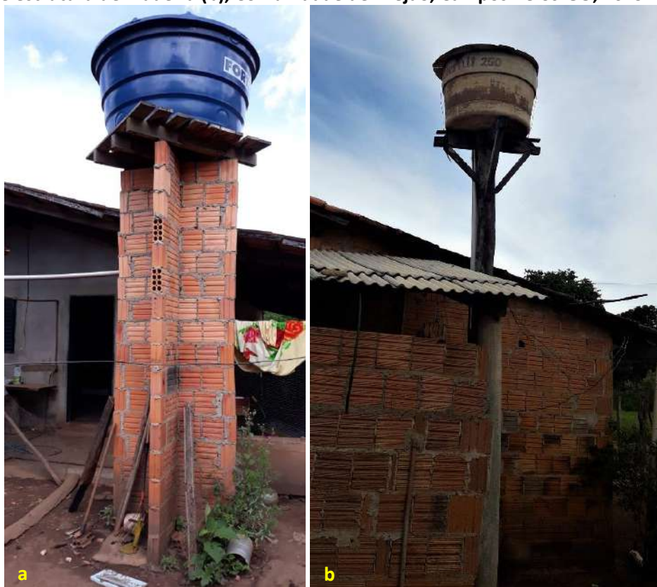
Foto 6.7 – Reservatório domiciliar instalado próximo ao telhado sobre estrutura de alvenaria (a) e outro sobre estrutura de madeira (b), Comunidade de Brejão, Campos Belos-GO, 2019.
