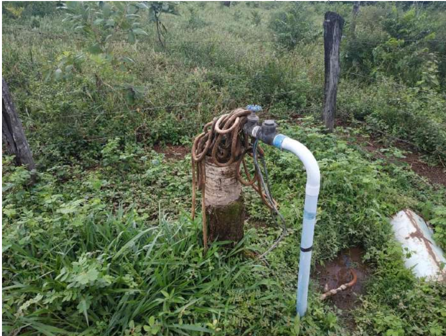
Foto 6.2 – Área de captação com poste de energia, cercas de isolamento e poço tubular profundo com água acumulada por vazamento, Comunidade de Brejão, Campos Belos-GO, 2019.
