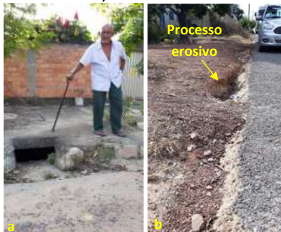
Foto 6.14 – Bueiro em frente ao lote (a) e processo erosivo na margem da via interna (b) da Comunidade Boa Nova, Professor Jamil-GO, 2019.
