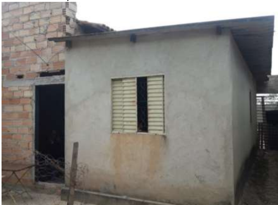
Foto 4.2 – Habitação construída de alvenaria com reboco e sem reboco, identificada na Comunidade Boa Nova, Professor Jamil-GO, 2019.
