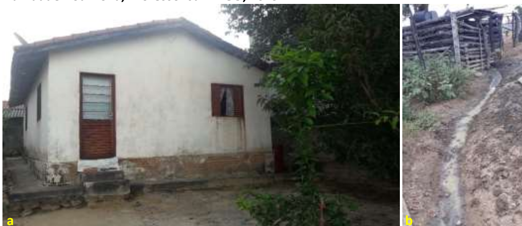
Foto 6.15 – Dispositivos de prevenção dos danos provocados pelas águas em residência (a) e lote (b) da Comunidade Boa Nova, Professor Jamil-GO, 2019.
