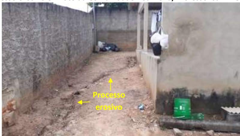
Foto 6.16 – Processo erosivo em lote da Comunidade Boa Nova, Professor Jamil-GO, 2019.
