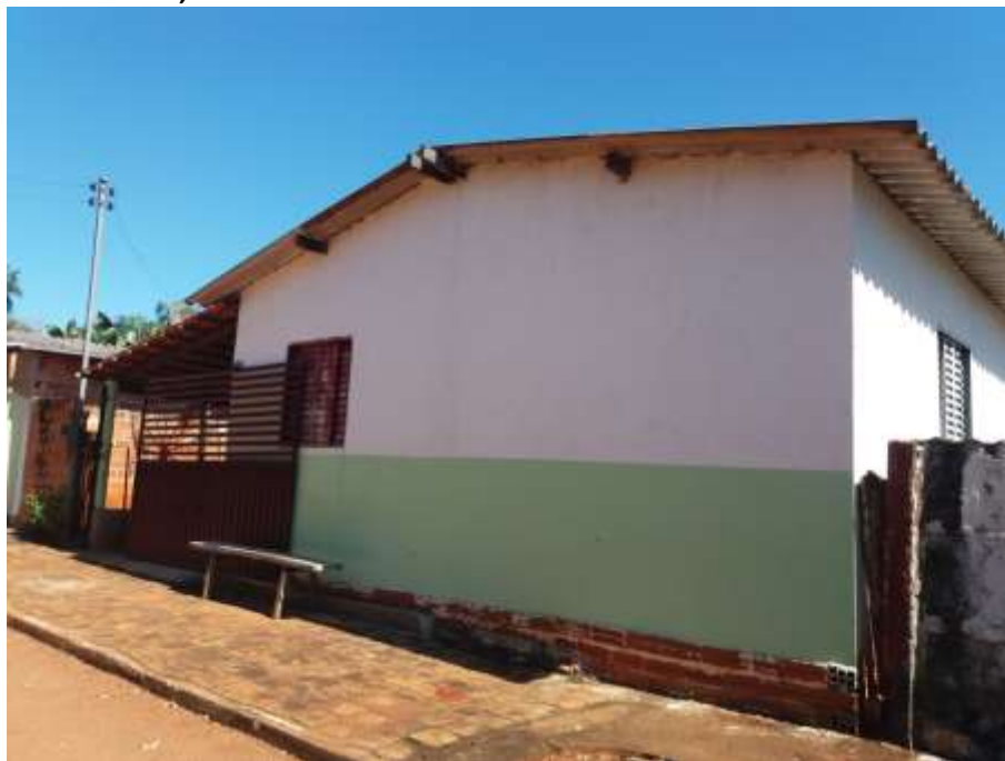
Foto 4.22 – Cobertura de fibrocimento, identificada na Comunidade de Balbino dos Santos, Santa Rita do Novo Destino-GO, 2019.
