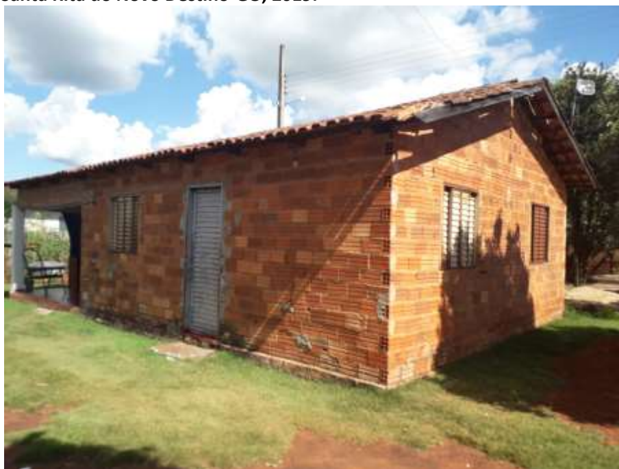
Foto 4.18 – Habitação construída de alvenaria sem reboco, identificada na Comunidade de Balbino dos Santos, Santa Rita do Novo Destino-GO, 2019.
