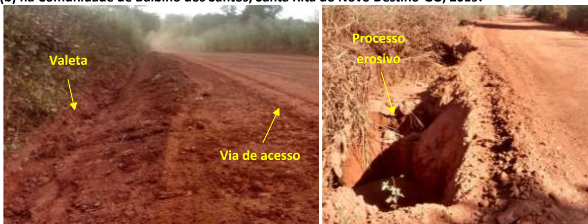
Foto 6.13 – Situação da drenagem pluvial na via de acesso: valeta de infiltração (a) e processo erosivo (b) na Comunidade de Balbino dos Santos, Santa Rita do Novo Destino-GO, 2019.
