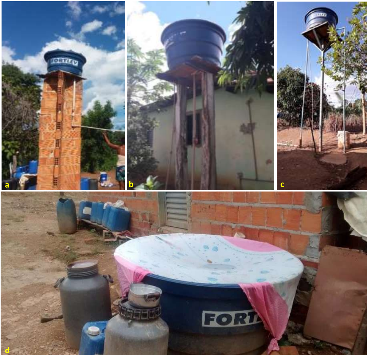
Foto 6.10 – Reservatório domiciliar em polietileno instalado sobre estrutura de alvenaria (a), de madeira (b), de ferro (c) ou tampado com pano e apoiado ao solo (d), na Comunidade de Baco Pari, Iaciara/Posse-GO, 2019.
