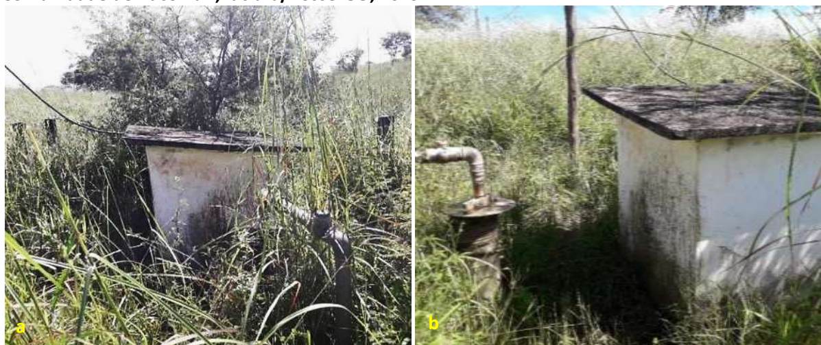
Foto 6.2 – Poço tubular profundo F1 e estrutura de alvenaria, em vista frontal (a) e lateral (b), na Comunidade de Baco Pari, Iaciara/Posse-GO, 2019.
