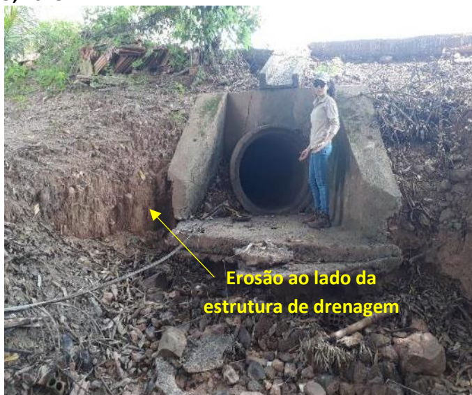
Foto 6.19 – Exemplo de processo erosivo nas margens da via de acesso à Comunidade Arraial da Ponte, Água Limpa-GO, 2018.
