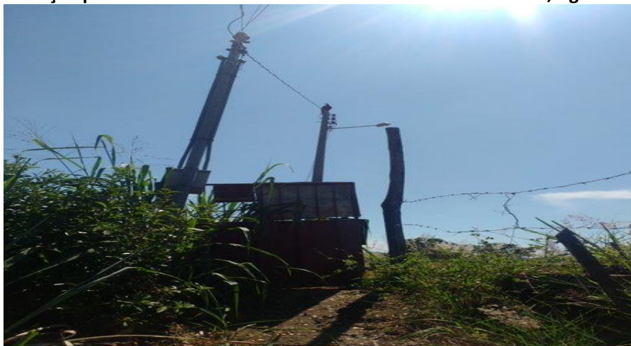
Foto 4.1 – Iluminação pública identificada na Comunidade do Arraial da Ponte, Água Limpa-GO, 2018.
