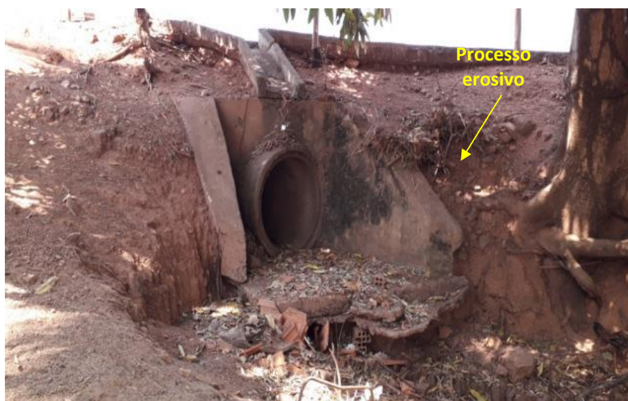
Foto 6.22 – Exemplo de processo erosivo em lote da Comunidade Arraial da Ponte, Água Limpa-GO, 2019.
