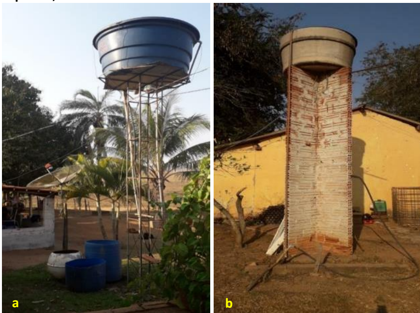
Foto 6.6 – Reservatórios domiciliares em polietileno com tampa apoiado em uma estrutura metálica (a) e um de fibrocimento instalado sobre uma estrutura em alvenaria (b) na Comunidade Arraial da Ponte, Água Limpa-GO, 2018.
