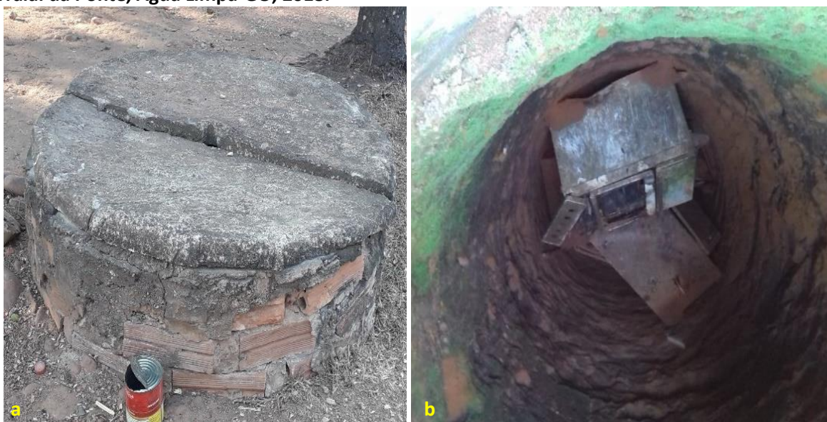
Foto 6.3 – Poço raso escavado desativado (a) e outro com lixo em seu interior (b), Comunidade Arraial da Ponte, Água Limpa-GO, 2018.
