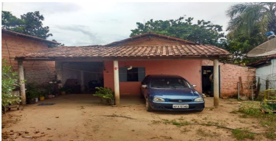
Foto 4.4 – Cobertura de telha de barro, identificada na Comunidade Arraial da Ponte, Água Limpa-GO, 2018.
