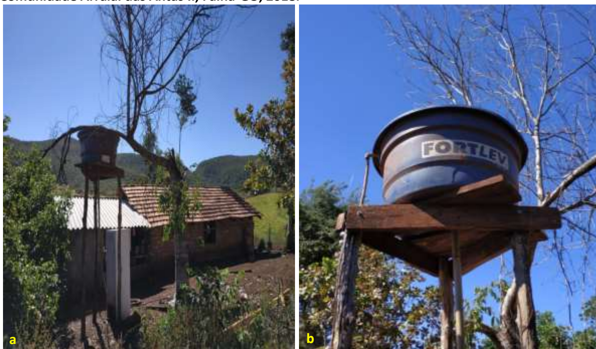
Foto 6.2 – Reservatório domiciliar de polietileno instalado sobre estrutura de madeira, na Comunidade Arraial das Antas II, Faina-GO, 2018.
