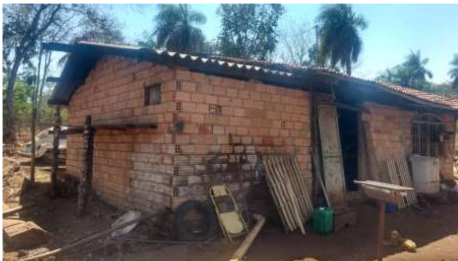
Foto 4.6 – Cobertura de telha fibrocimento, identificada na Comunidade Arraial das Antas II, Faina- GO, 2018.
