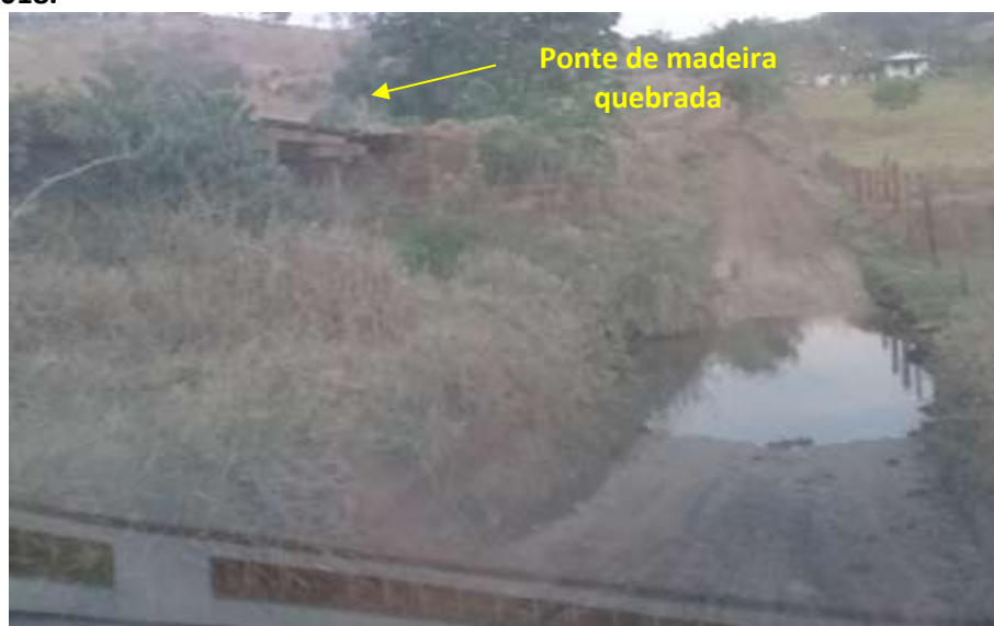
Foto 6.15 – Ponte quebrada sobre curso d'água na via de acesso da Comunidade Arraial das Antas II, Faina-GO, 2018.
