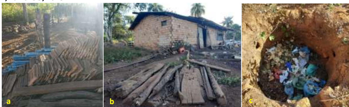
Foto 6.12 – Presença, nos quintais, de materiais de construção tipo: telhas cerâmica, madeira e tubos (a), resíduos variados espalhados (b) e acumulados em buracos (c) na Comunidade Arraial das Antas II, Faina-GO, 2018.
