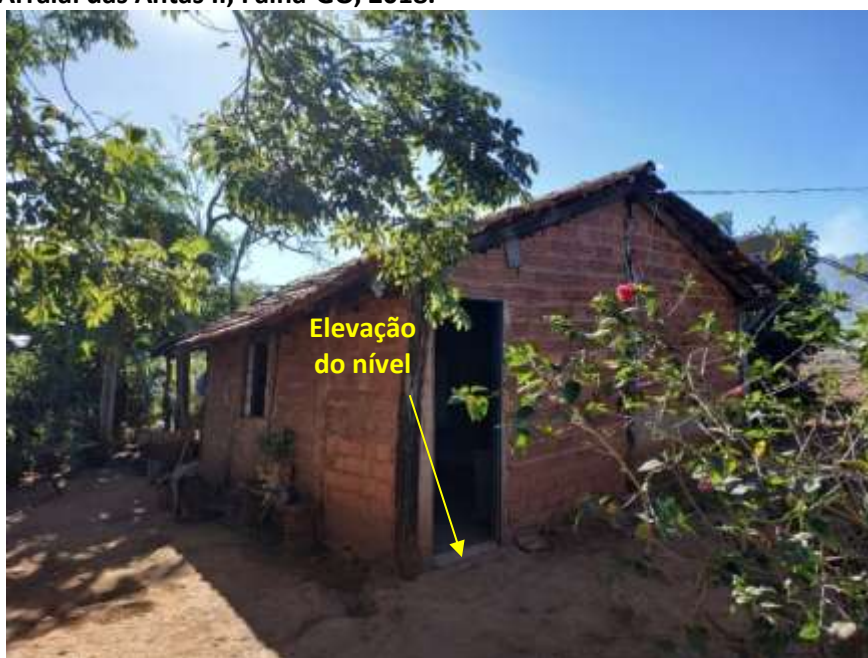
Foto 6.19 – Dispositivo de prevenção dos danos provocados pelas águas em residência da Comunidade Arraial das Antas II, Faina-GO, 2018.
