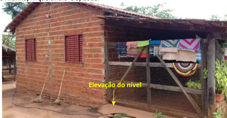
Foto 6.18 – Dispositivo de prevenção dos danos provocados pelas águas em residência da Comunidade Aranha, Niquelândia-GO, 2018.
