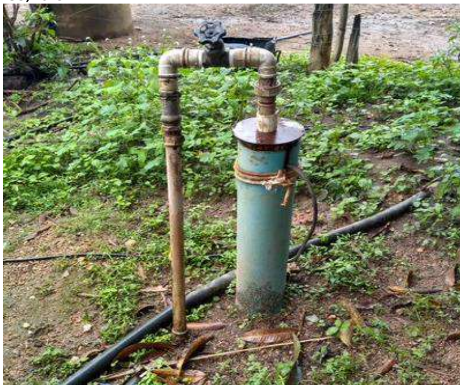
Foto 6.1 – Poço tubular raso do Sistema de Abastecimento de Água (SAA), Comunidade Aranha, Niquelândia-GO, 2018.
