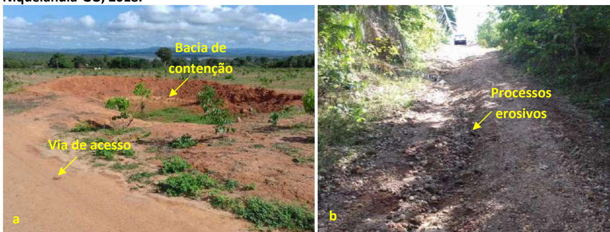
Foto 6.15 – Bacia de contenção (a) e processos erosivos (b) na via de acesso à Comunidade Aranha, Niquelândia-GO, 2018.
