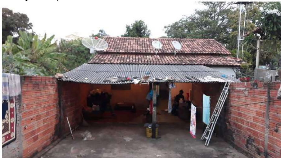
Foto 4.7 – Cobertura de fibrocimento em associação com telha de barro, identificada na Comunidade Ana Laura, Piracanjuba-GO, 2019.
