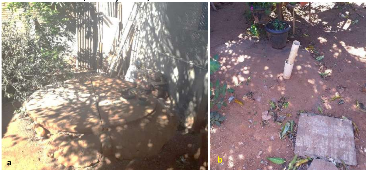
Foto 6.3 – Situações construtivas das fossas negras/rudimentares, com tampa de concreto e sem tubulação de respiro (a), abaixo do nível do solo e com tubulação de respiro sem proteção (b), na Comunidade Ana Laura, Piracanjuba-GO, 2019.
