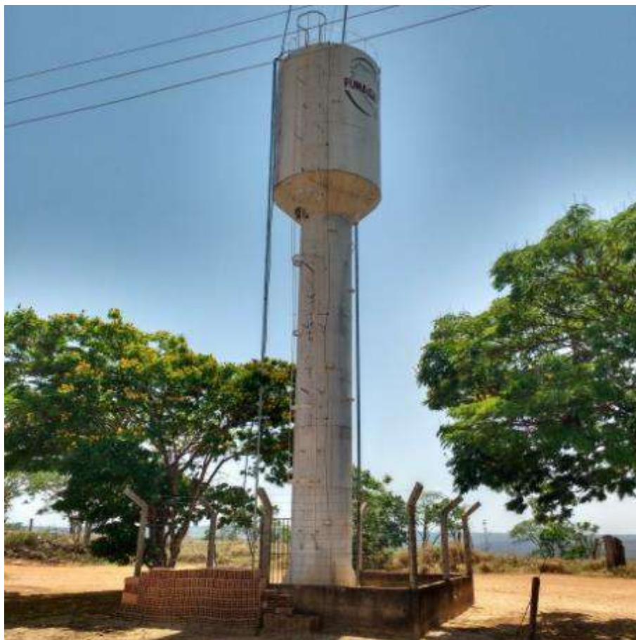
Foto 6.5 – Reservatório elevado R2 protegido por cercas na Comunidade dos Almeidas, Silvânia-GO, 2018.
