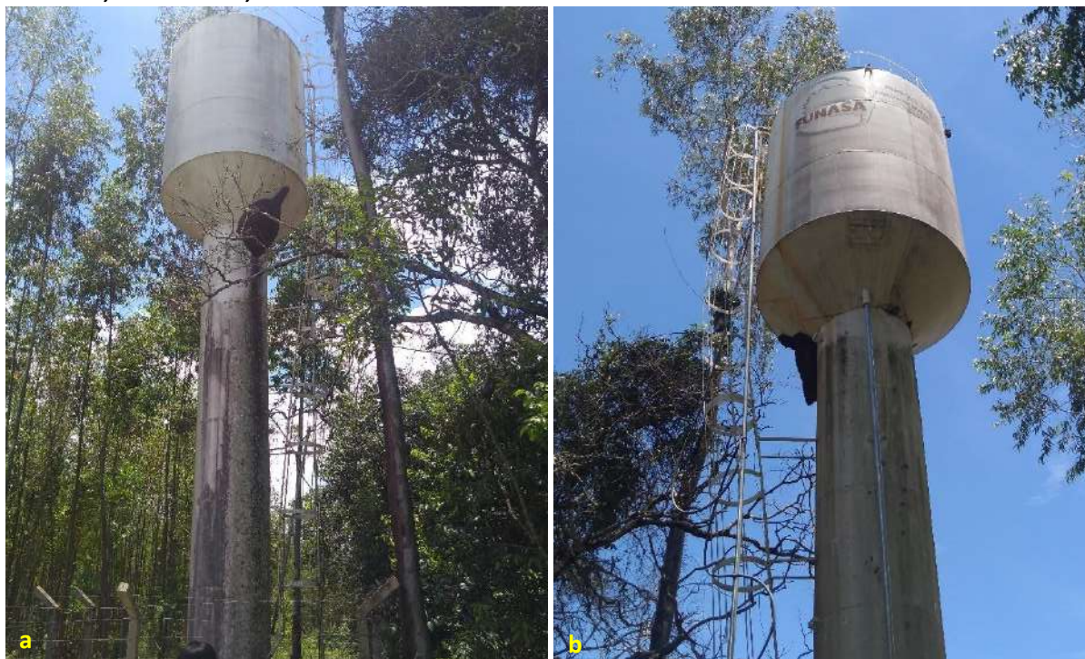
Foto 6.7 – Reservatório elevado R3 (a), protegido por cercas e portão (b), na Comunidade dos Almeidas, Silvânia-GO, 2018.
