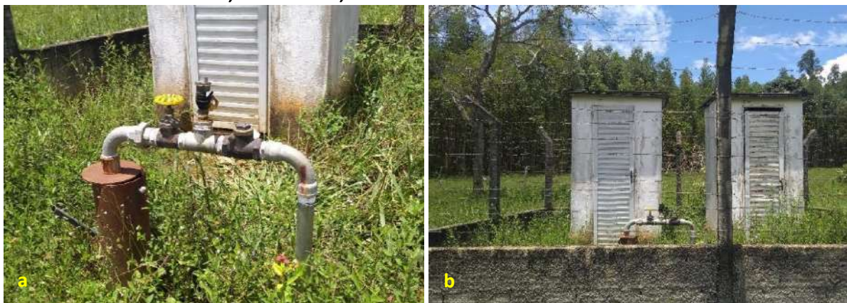
Foto 6.6 – Terceiro ponto de captação do SAA, composto por poço tubular profundo cercado (a) com estruturas de alvenaria para proteção do sistema elétrico e dosador de cloro (inativo) (b), na Comunidade dos Almeidas, Silvânia-GO, 2018.
