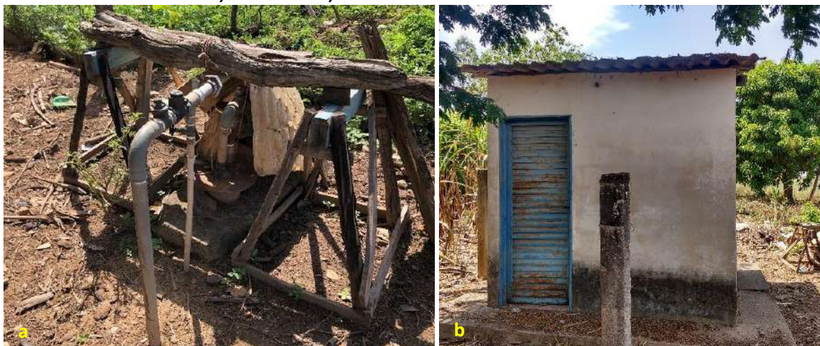
Foto 6.2 – Primeiro ponto de captação do SAA composto por poço tubular profundo (F1) protegido por material improvisado (a) e o sistema elétrico protegido por estrutura de alvenaria (b), na Comunidade dos Almeidas, Silvânia-GO, 2018.
