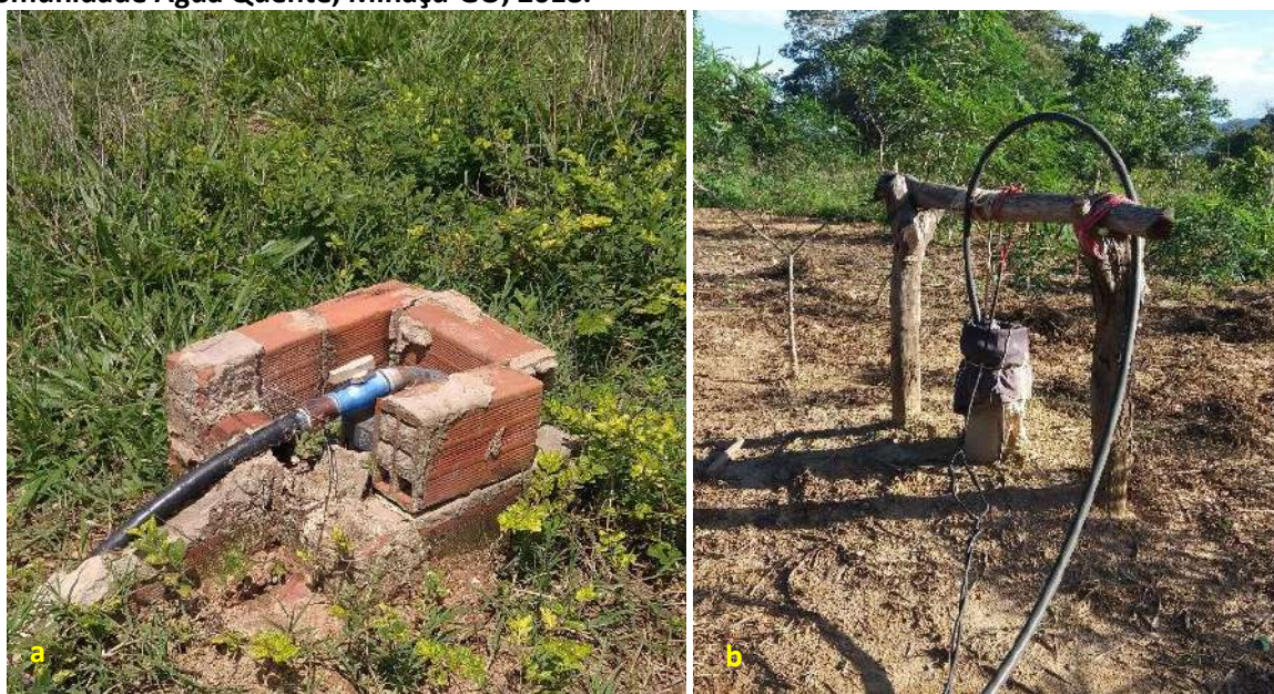
Foto 6.4 - Poço tubular profundo em abrigo de tijolos (a), sem dispositivos de proteção (b), na Comunidade Água Quente, Minaçu-GO, 2018.
