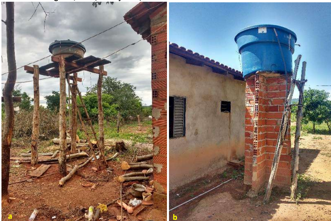
Foto 6.6 – Reservatórios domiciliares instalados sobre estrutura em madeira (a) e em alvenaria (b), na Comunidade Água Quente, Minaçu-GO, 2018.
