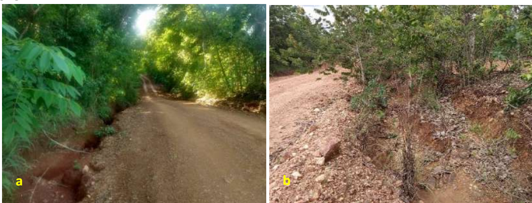
Foto 6.18 – Processos erosivos nas margens da via de acesso à Comunidade Água Quente, Minaçu-GO, 2018.
