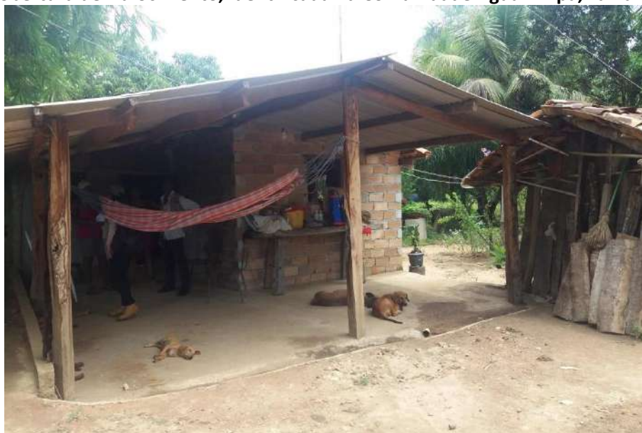
Foto 4.9 – Cobertura de fibrocimento, identificada na Comunidade Água Limpa, Faina-GO, 2019.
