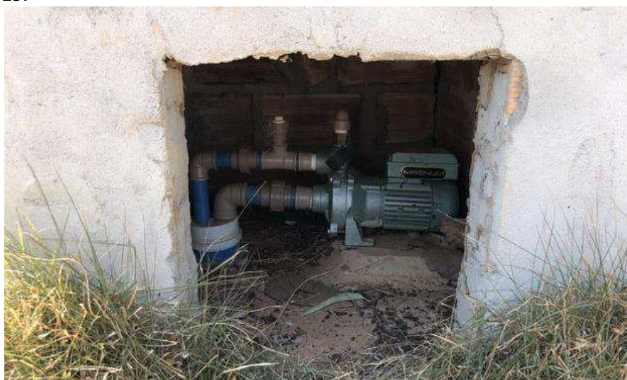
Foto 6.2 – Poço tubular raso protegido por estrutura de alvenaria, na Comunidade Água Limpa, Faina-GO, 2019.
