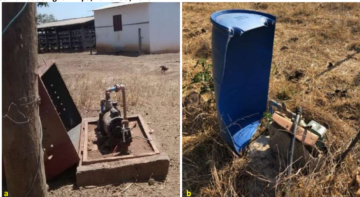
Foto 6.3 – Poços tubulares rasos protegidos por abrigo metálico (a) e por bombona cortada (b), na Comunidade Água Limpa, Faina-GO, 2019.
