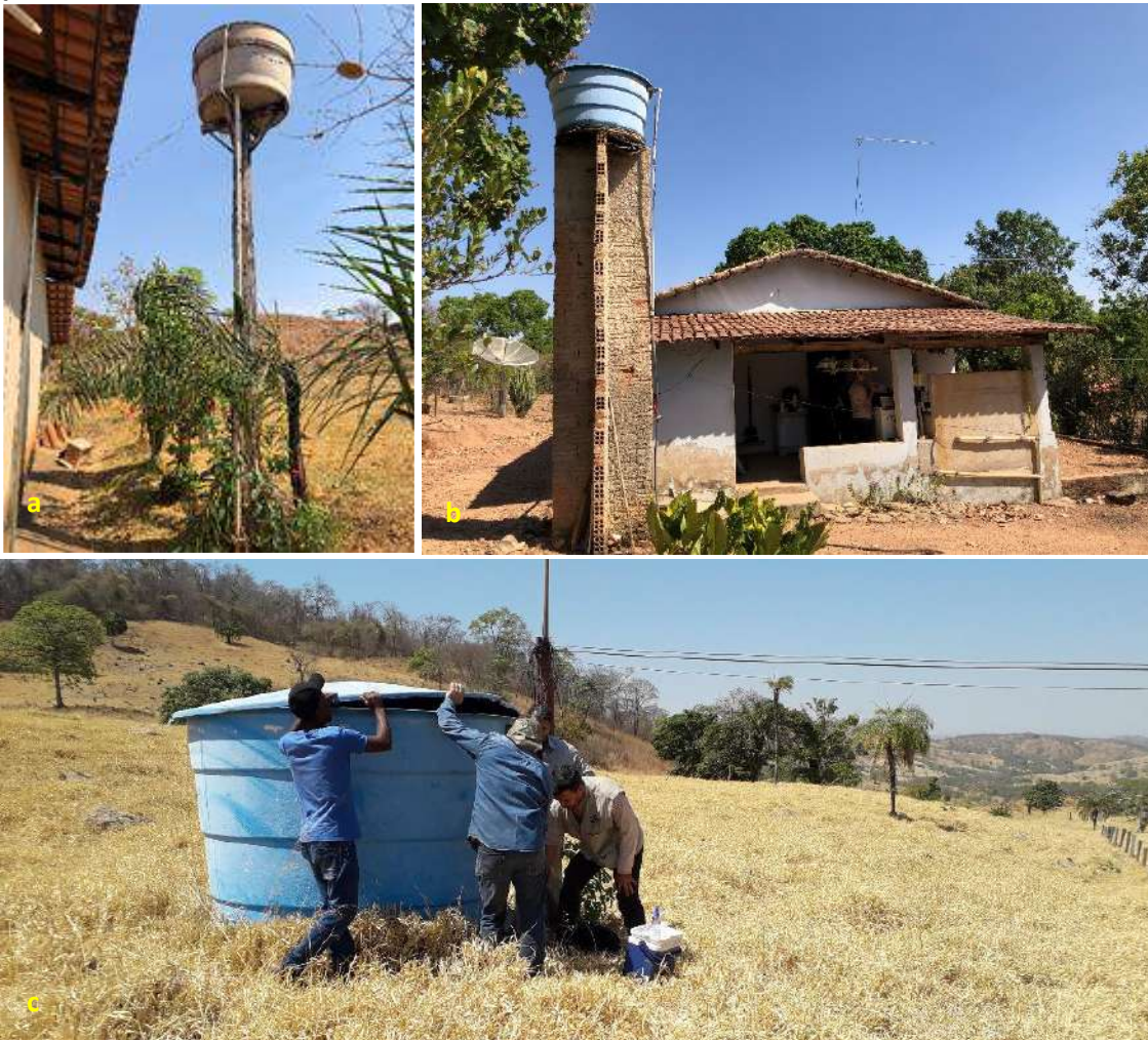
Foto 6.7 – Reservatórios domiciliares em fibrocimento, instalados sobre estrutura de madeira (a), em fibras de vidro sobre estrutura de alvenaria (b) e apoiados ao solo (c), na Comunidade Água Limpa, Faina-GO, 2019.
