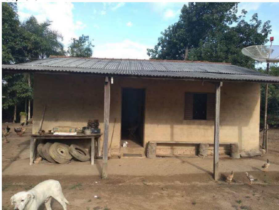
Foto 4.11 – Cobertura de telha de zinco, identificada nas habitações da Comunidade Acaba Vida, Niquelândia-GO, 2018.
