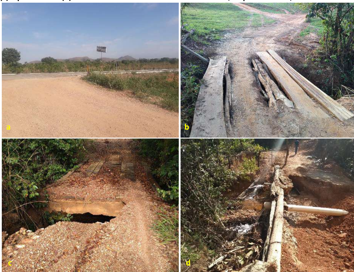
Foto 6.16 – Via de acesso após sair da rodovia (a), ponte em condição precária (b), ponte intransitável (c) e ponte caída (d) na via de acesso à Comunidade Acaba Vida, Niquelândia-GO, 2018.
