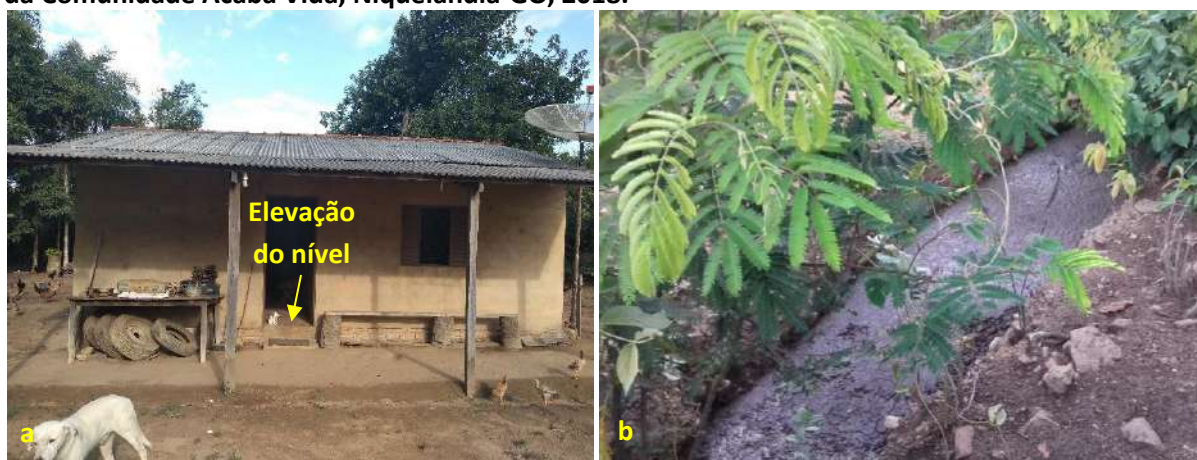
Foto 6.22 – Dispositivos de prevenção dos danos provocados pelas águas em residência (a) e lote (b) da Comunidade Acaba Vida, Niquelândia-GO, 2018.
