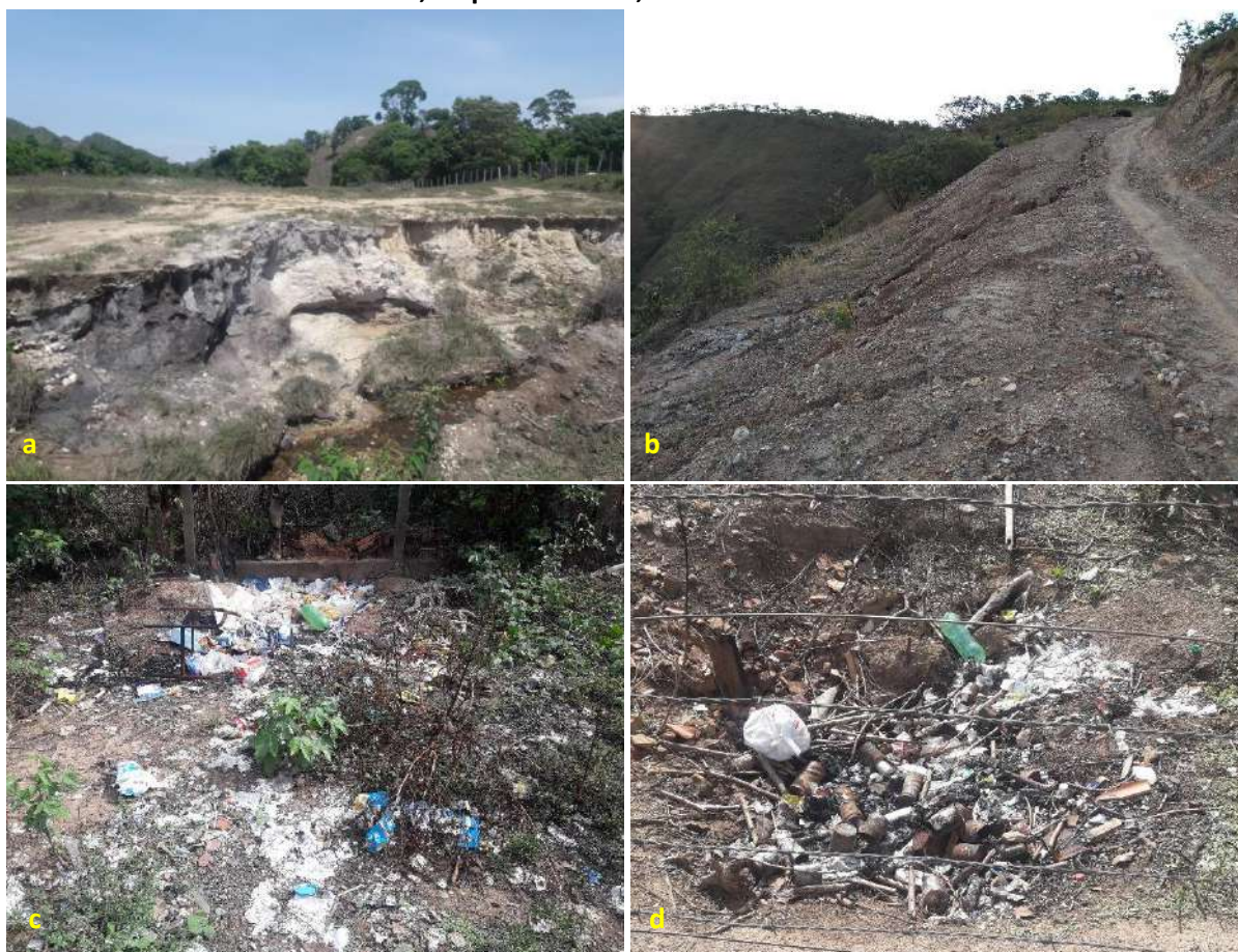
Foto 6.18 – Processos erosivos (a), (b) e pontos de descarte de resíduos sólidos (c), (d), na via de acesso à Comunidade Acaba Vida, Niquelândia-GO, 2018.
