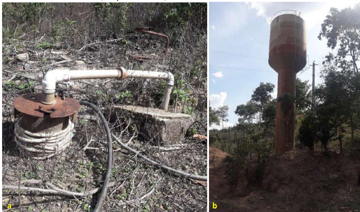
Foto 6.3 – Componentes do SAA2 desativado, poço tubular profundo (a) e reservatório tipo taça (b), na Comunidade Acaba Vida, Niquelândia-GO, 2018.
