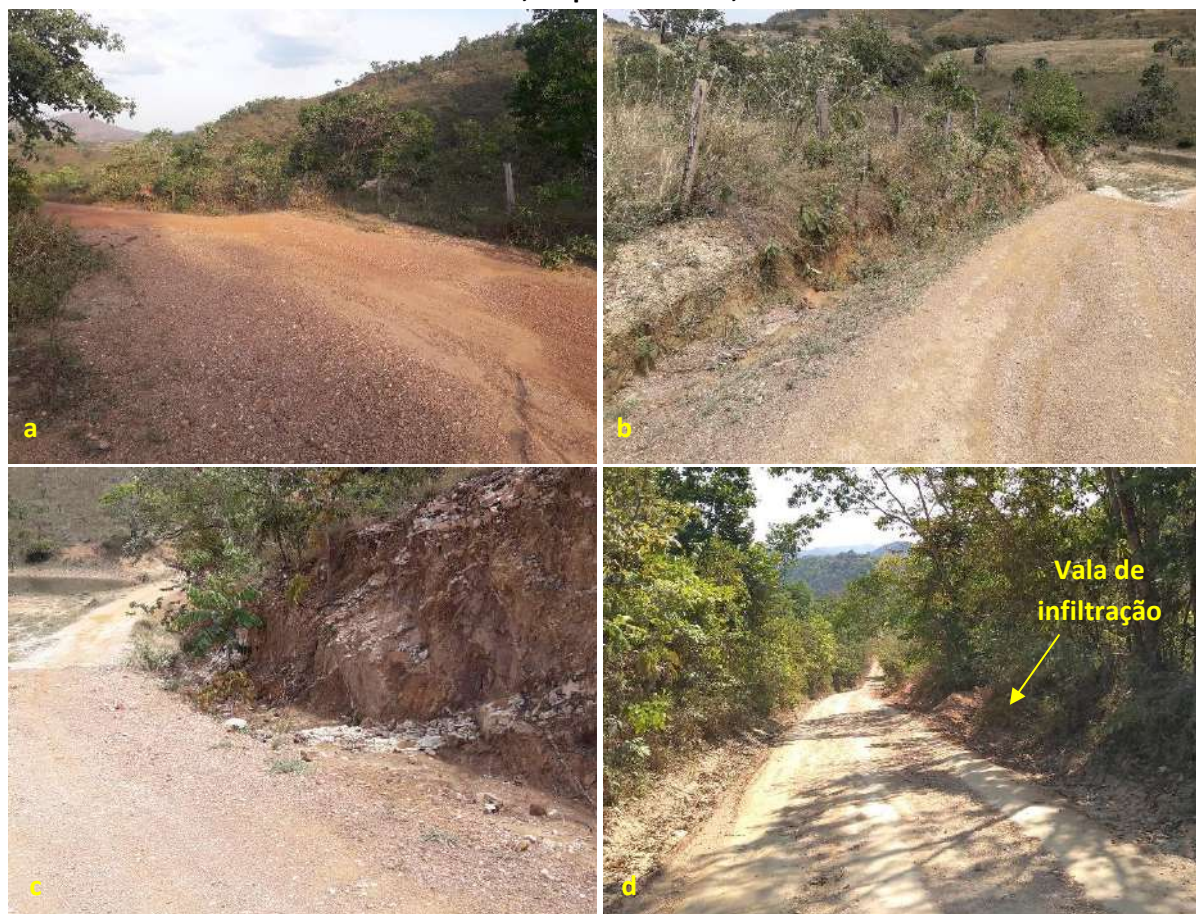
Foto 6.17 – Curva de nível cruzando a via de acesso (a), vala de infiltração (a) e processo erosivo (b) na via de acesso à Comunidade Acaba Vida, Niquelândia-GO, 2018.
