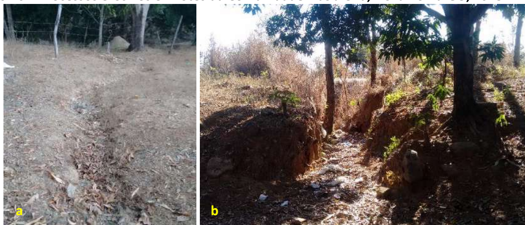
Foto 6.20 – Processos erosivos em lotes da Comunidade Abobreira, Nova Roma-GO, 2018.
