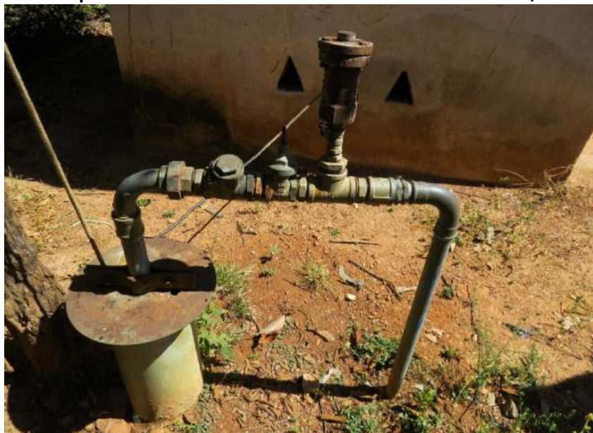
Foto 6.1 – Poço tubular profundo utilizado no SAA da Comunidade Abobreira, Nova Roma-GO, 2018.
