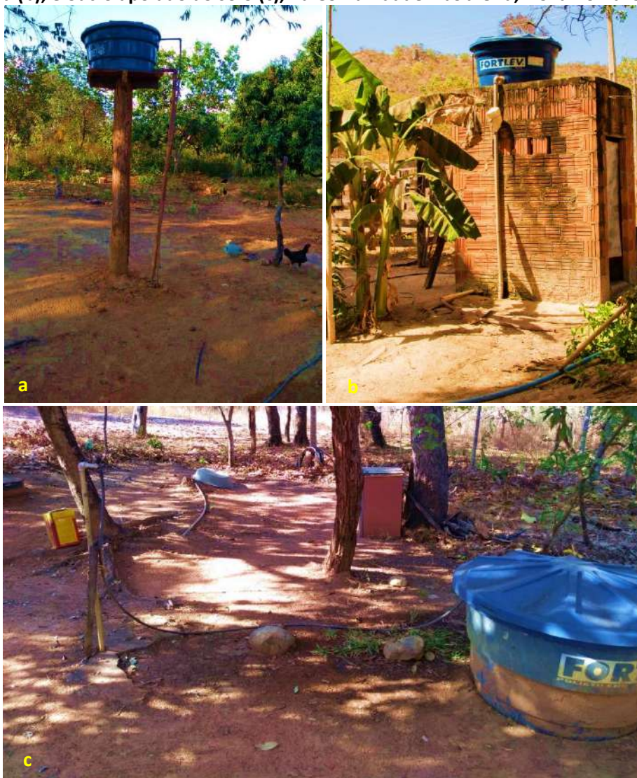
Foto 6.6 – Reservatório domiciliar em polietileno com tampa, instalado sobre estrutura de madeira (a), alvenaria (b), e outro apoiado ao solo (c), na Comunidade Abobreira, Nova Roma-GO, 2018.
