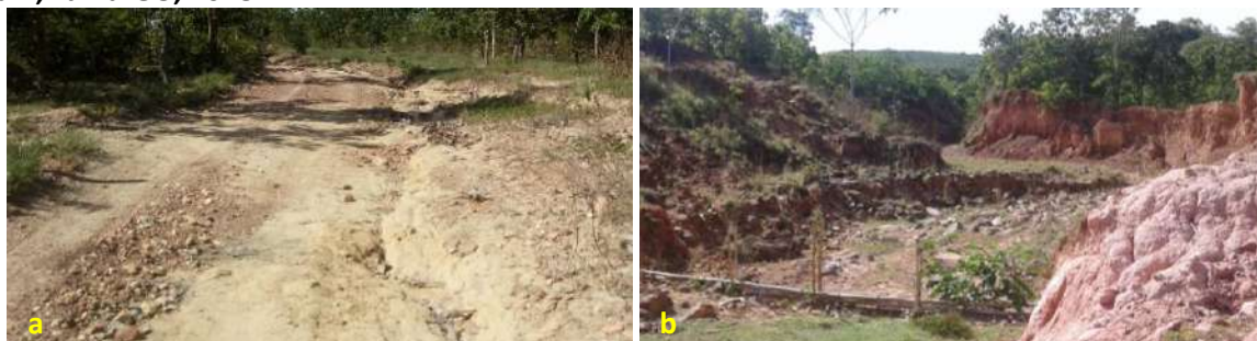
Foto 6.15 – Processos erosivos na via (a) e nas margens da via de acesso (b) à Comunidade 17 de Abril, Faina-GO, 2018.
