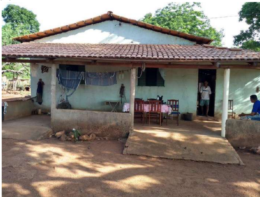
Foto 4.7 – Cobertura de telha de barro, identificada nas habitações da Comunidade 17 de Abril, Faina-GO, 2018.
