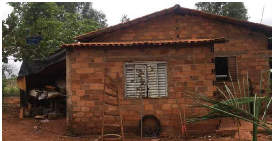
Foto 4.2 – Habitação construída de alvenaria sem reboco, identificada na Comunidade 17 de Abril, Faina-GO, 2018.
