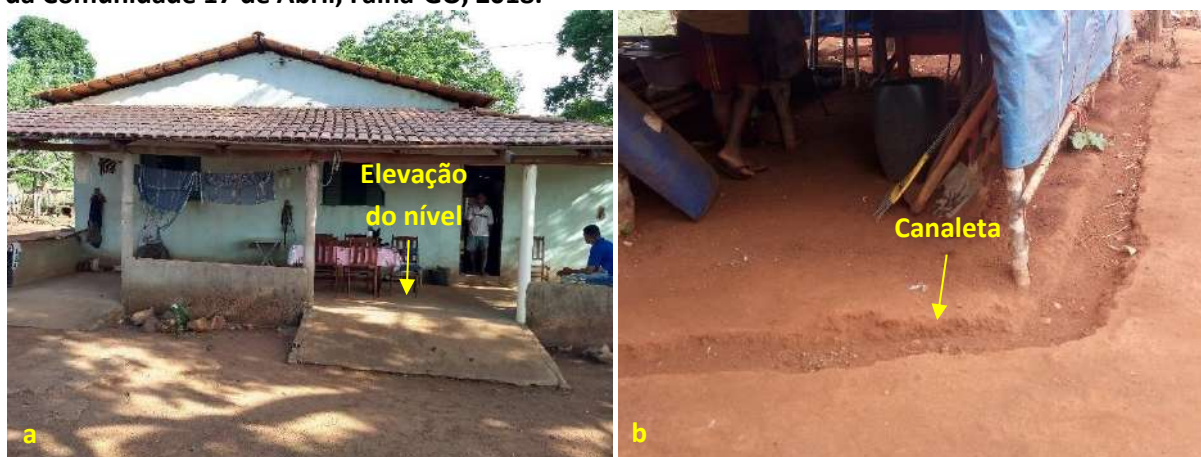
Foto 6.21 – Dispositivos de prevenção dos danos provocados pelas águas em residência (a) e lote (b) da Comunidade 17 de Abril, Faina-GO, 2018.
