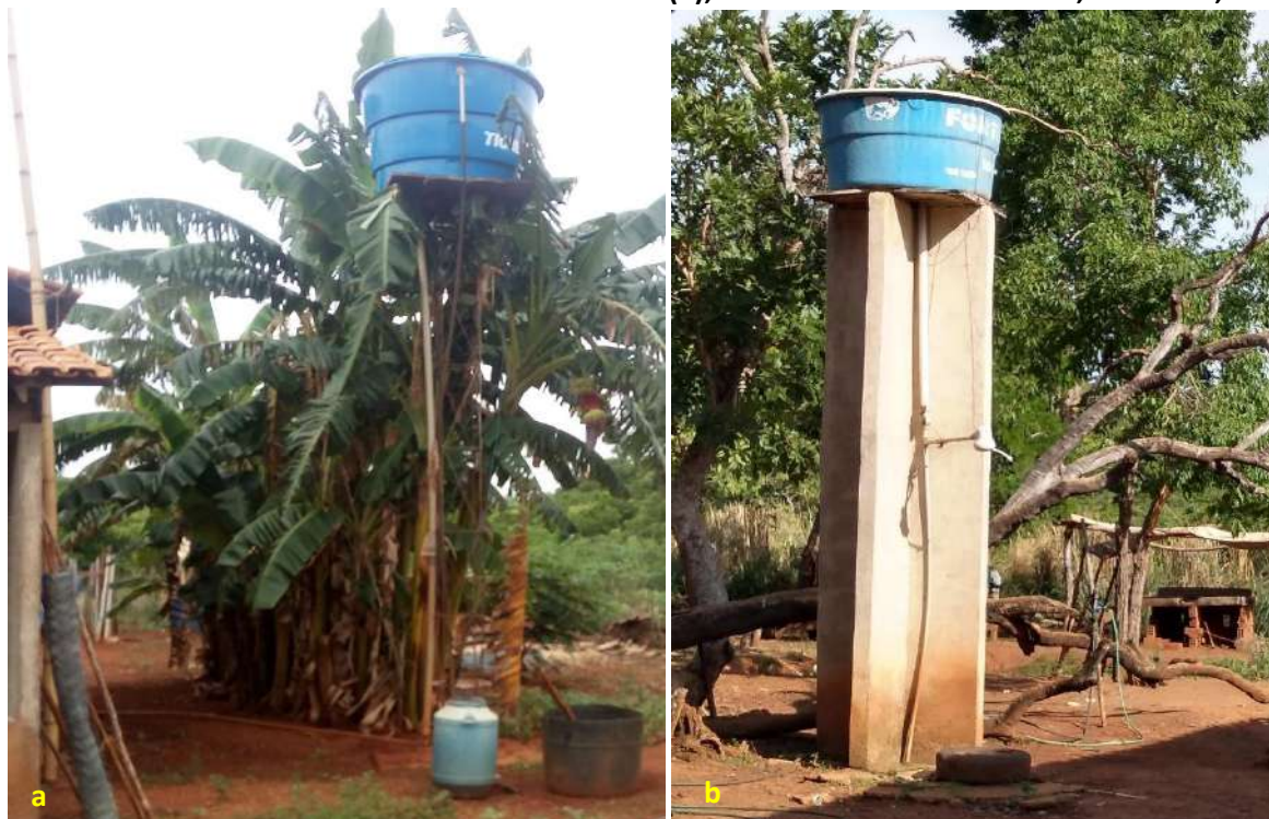
Foto 6.3 – Reservatório domiciliar em polietileno instalado sobre estrutura em madeira (a) e outro em fibra de vidro sobre uma estrutura em alvenaria (b), na Comunidade 17 de Abril, Faina-GO, 2018.
