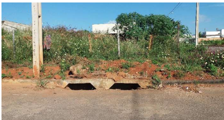
Foto 6.8 – Bueiro em frente a lote de morador da Comunidade Valdemar de Oliveira, Goianésia-GO, 2019.
