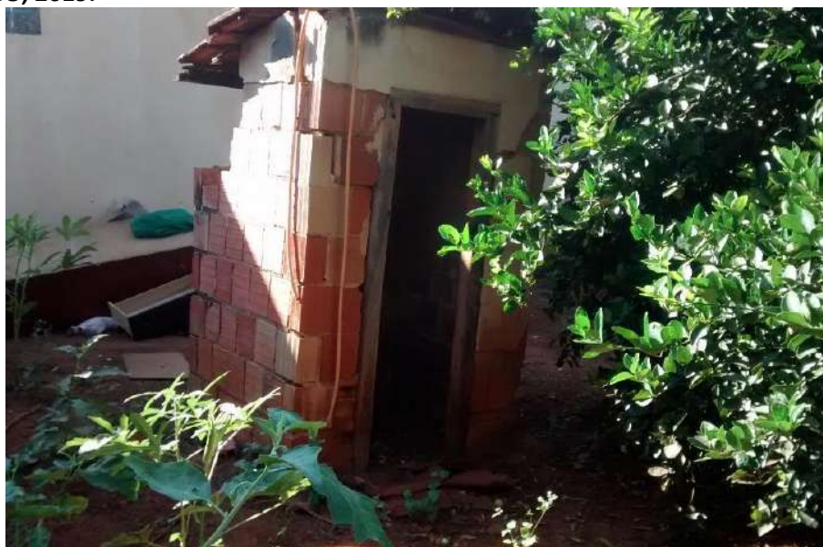
Foto 6.4 – Exemplo da situação de privada fora do domicílio, na Comunidade Valdemar de Oliveira, Goianésia-GO, 2019.
