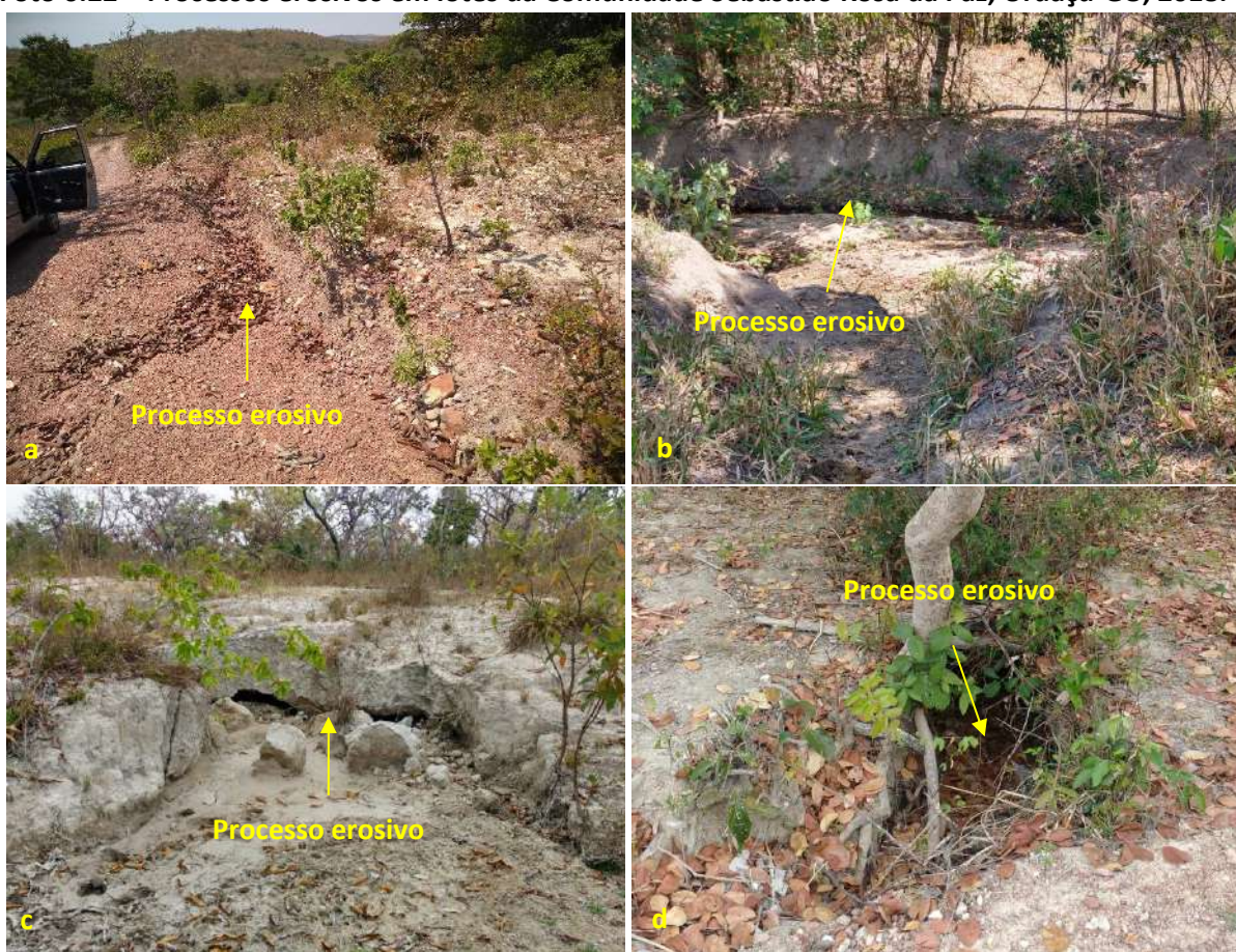
Foto 6.22 – Processos erosivos em lotes da Comunidade Sebastião Rosa da Paz, Uruaçu-GO, 2018.
