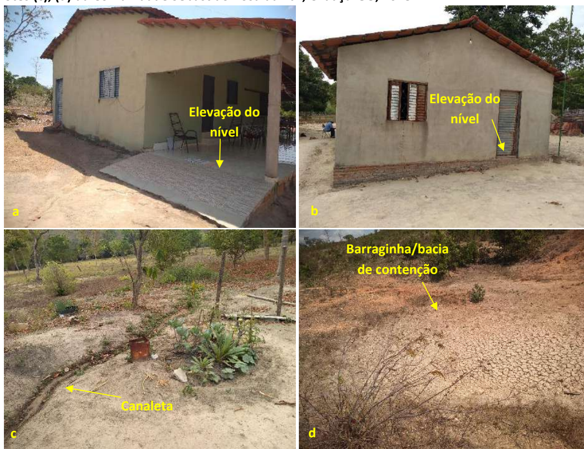
Foto 6.21 – Dispositivos de prevenção dos danos provocados pelas águas em residências (a), (b) e lotes (c), (d) da Comunidade Sebastião Rosa da Paz, Uruaçu-GO, 2018.
