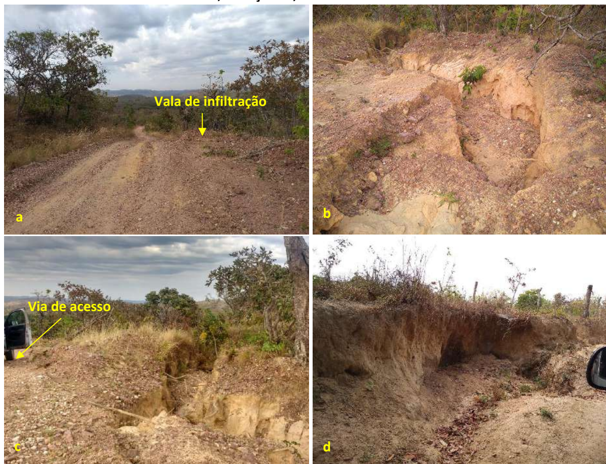
Foto 6.16 – Vala de infiltração (a) e processos erosivos nas margens da via de acesso (b), (c) e (d) à Comunidade Sebastião Rosa da Paz, Uruaçu-GO, 2018.
