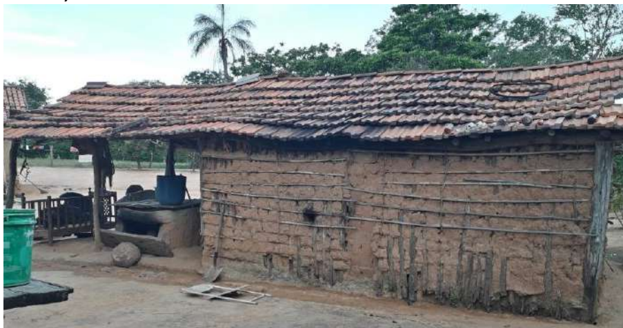
Foto 4.9 – Habitação construída de pau a pique, identificada na Comunidade de Pelotas, Monte Alegre de Goiás-GO, 2019.
