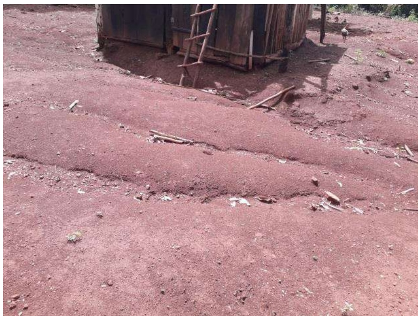
Foto 6.22 – Processo erosivo em lote da Comunidade de Mimoso (Queixo Dantas), Mimoso de Goiás-GO, 2019.
