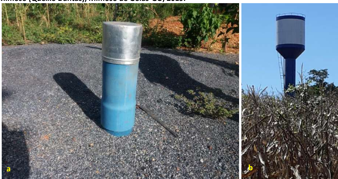
Foto 6.4 – Novo SAA dotado de poço tubular profundo e reservatório elevado, na Comunidade de Mimoso (Queixo Dantas), Mimoso de Goiás-GO, 2019.
