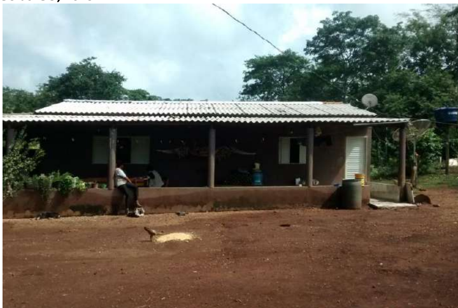
Foto 4.11 – Cobertura de fibrocimento, identificada na Comunidade de Mimoso (Queixo Dantas), Mimoso de Goiás-GO, 2019.
