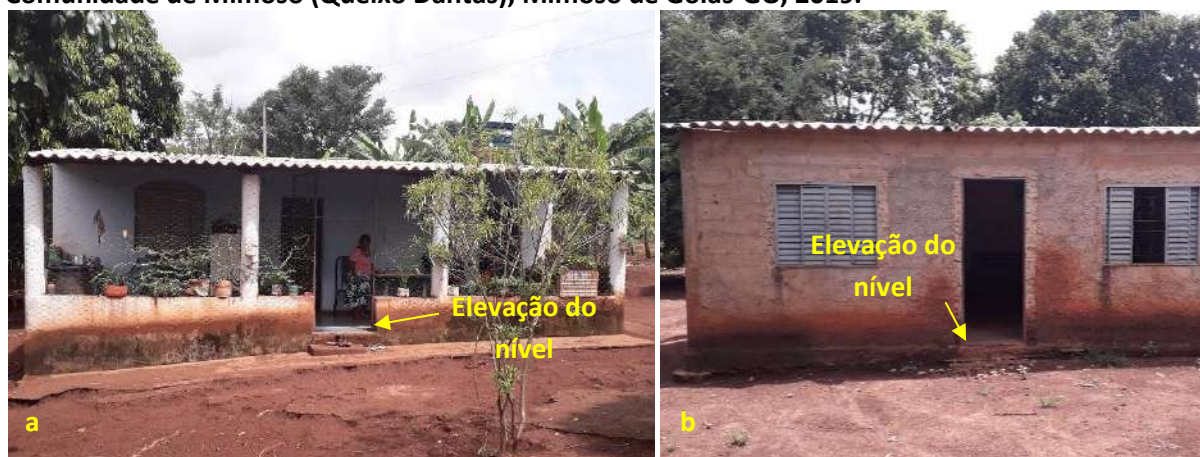
Foto 6.21 – Dispositivos de prevenção dos danos provocados pelas águas em residências da Comunidade de Mimoso (Queixo Dantas), Mimoso de Goiás-GO, 2019.
