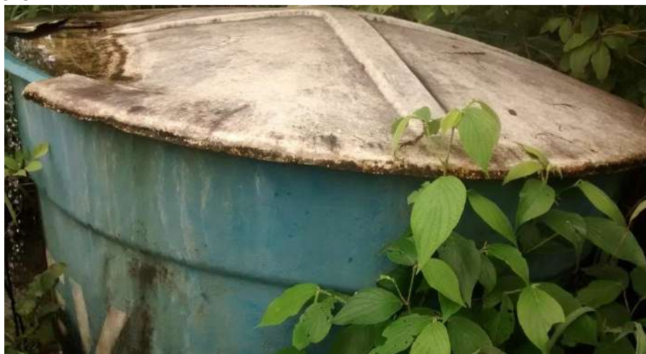
Foto 6.3 – Reservatório do SAA transbordando pela fissura da tampa, Queixo Dantas, Mimoso de Goiás-GO, 2019.
