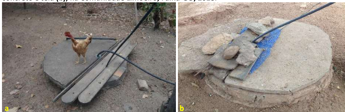
Foto 6.4 – Poço raso escavado tampado de forma improvisada, com concreto e madeira (a), ou com concreto e tela (b), na Comunidade Limoeiro, Faina-GO, 2018.
