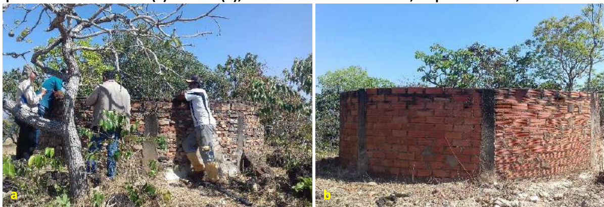
Foto 6.3 – Reservatórios desativados do SAA com capacidade de armazenamento para aproximadamente 25m 3 (a) e 27 m 3 (b), na Comunidade José Martí, Niquelândia-GO, 2018.
