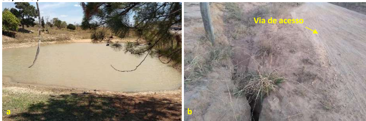
Foto 6.18 – Bacia de contenção (a) e processos erosivos (b) na Comunidade José Martí, Niquelândia-GO, 2018.,
