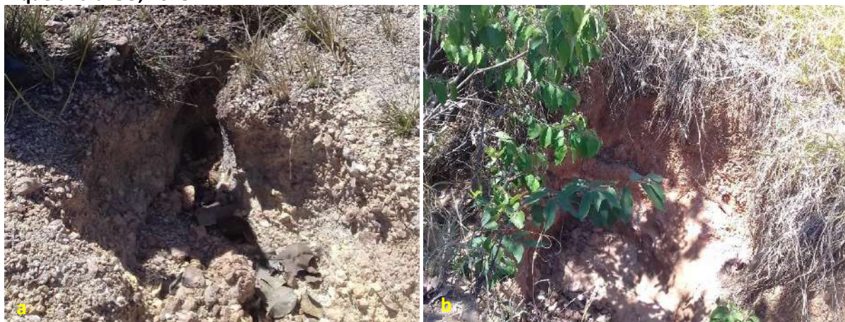
Foto 6.19 – Processos erosivos (a) e (b) nas margens da via de acesso à Comunidade José Martí, Niquelândia-GO, 2018.
