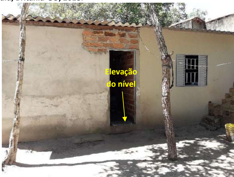
Foto 6.18 – Dispositivo de prevenção dos danos provocados pelas águas em residência da Comunidade Itacaiú, Britânia-GO, 2018.
