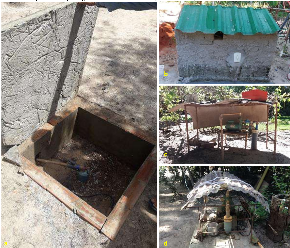
Foto 6.2 – Poço tubular raso abrigado em estrutura de alvenaria (a e b) e protegido por materiais de forma improvisada (c e d), na Comunidade Itacaiú, Britânia-GO, 2018.
