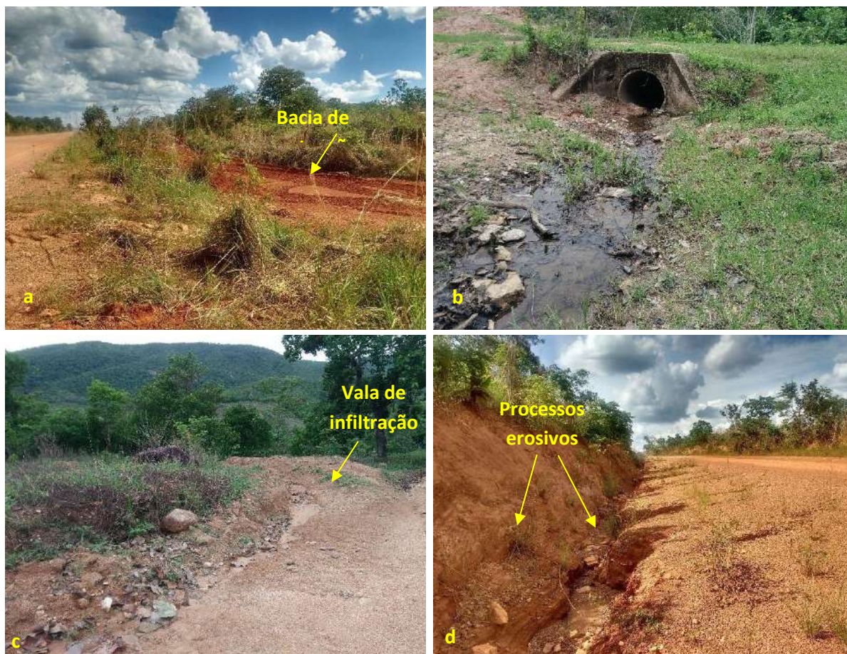
Foto 6.21 – Situação da drenagem pluvial na via de acesso: bacia de contenção (a), bueiro (b), vala de infiltração (c) e processos erosivos (d), na Comunidade Céu Azul, Minaçu-GO, 2018.
