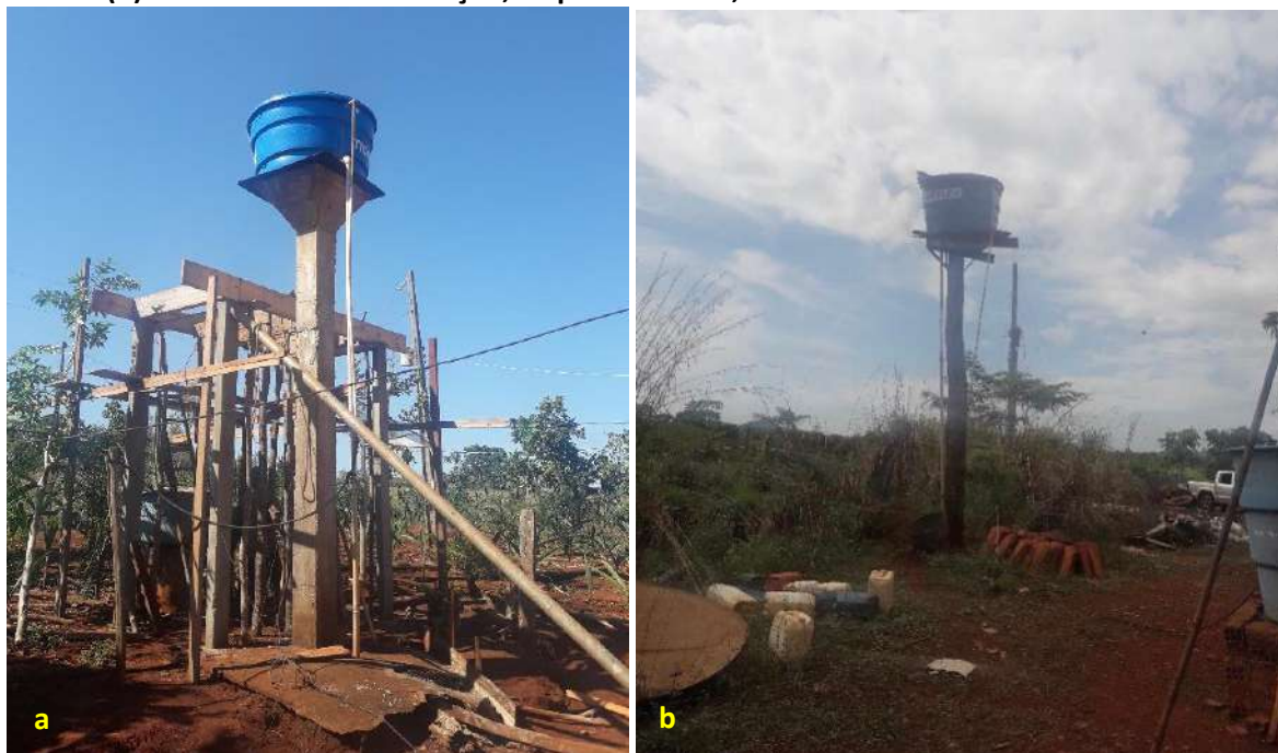
Foto 6.5 – Reservatórios domiciliares instalados sobre diferentes estruturas: em alvenaria (a), em madeira (b) na Comunidade Conceição, Niquelândia-GO, 2018.
