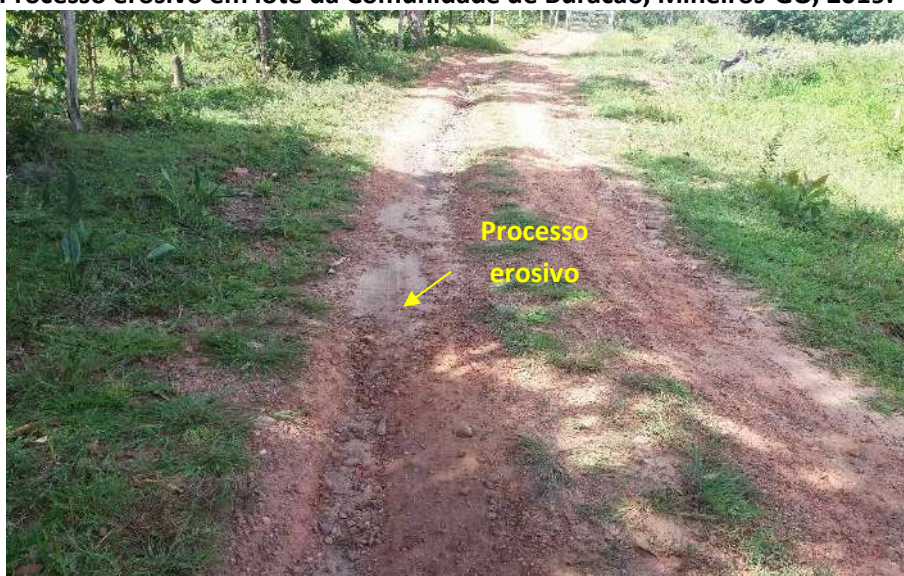
Foto 6.20 – Processo erosivo em lote da Comunidade de Buracão, Mineiros-GO, 2019.
