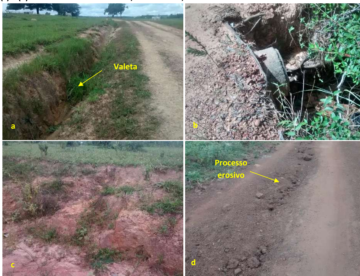
Foto 6.15 – Situação da drenagem pluvial na via de acesso: valeta (a), bueiro (b) e processos erosivos (c) e (d) na Comunidade de Buracão, Mineiros-GO, 2019.
